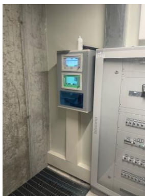
Centralina allarme locale tecnico piano terra
